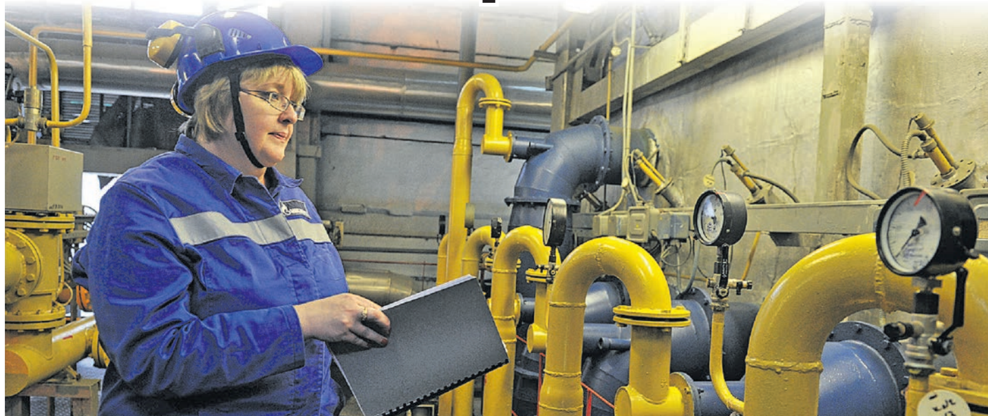
Теплоисточники заработали на полную мощность.
